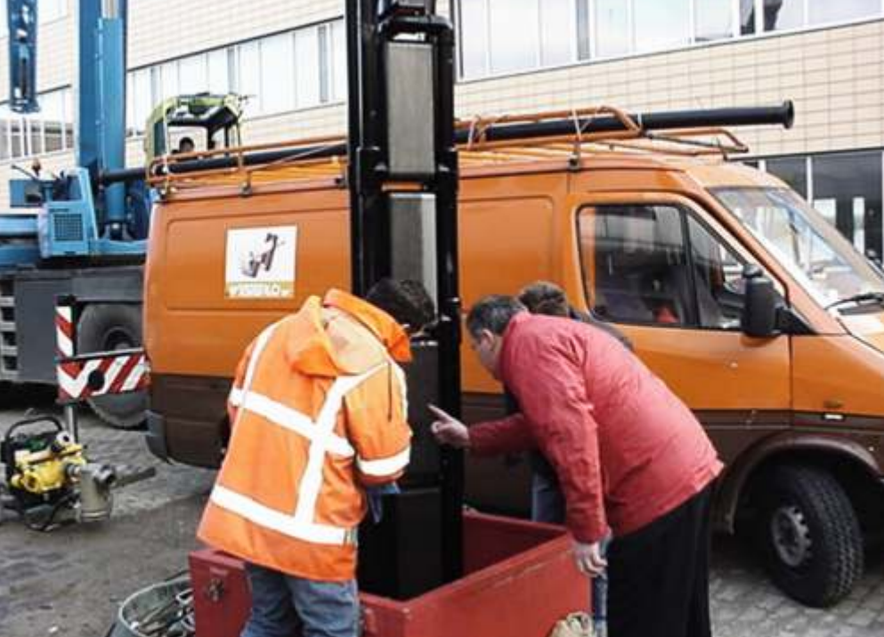
检查荷兰韦斯特洛 GeoThermic 系统。SWEP B45 钎焊板式换热器正在装入井眼中。
